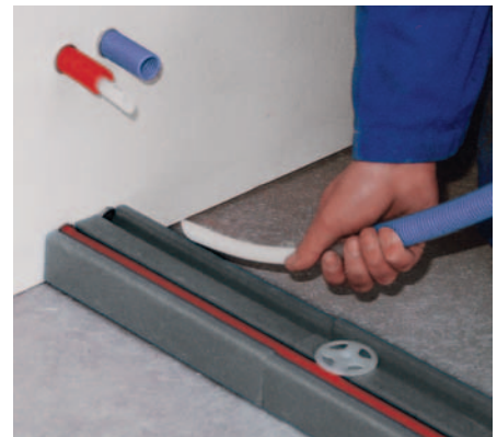
Einführen der Anschlussleitung in den PEBE-Block
